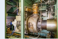
IHI製2MW級ガスタービン
