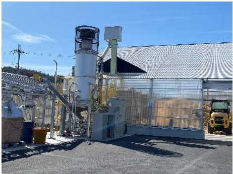
ライスセンター直結の炭化炉（YES） 現地加水バイオ炭製造（水分40%） （問題①解決）
