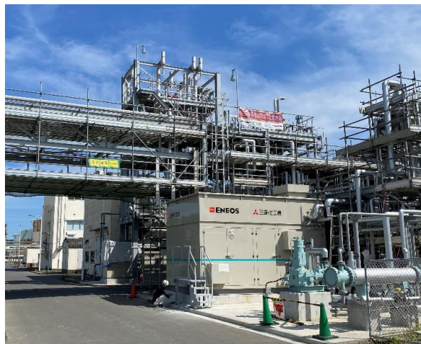
合成ガス製造 (逆シフト反応設備)
