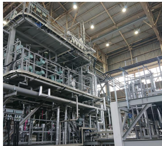
合成粗油製造 (FT合成反応設備)
