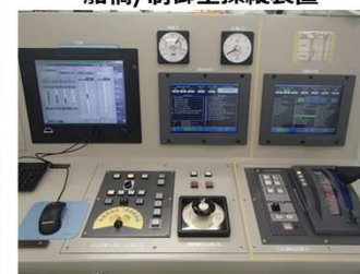
船橋/制御室操縦装置
