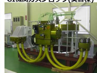
GI機関ガスブロック(実習棟)
