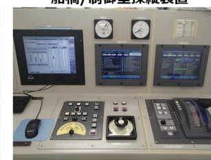
船橋/制御室操縦装置
