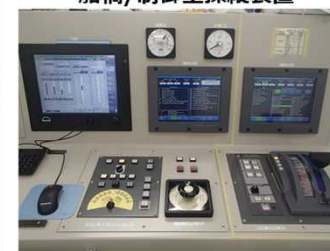
船橋/制御室操縦装置
