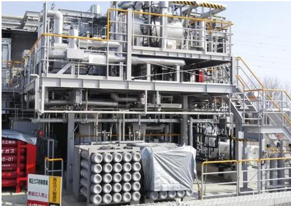
図 日揮がFREA内に建設したアンモニア合成プラント
