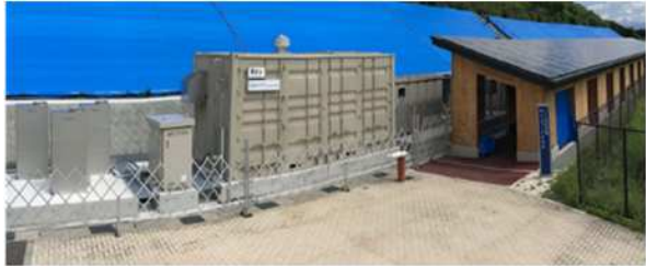
25kW大面積 セルスタック評価設備
