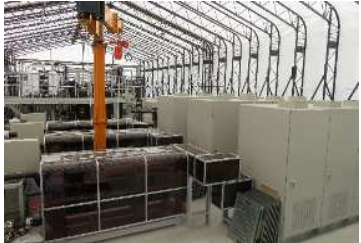
750kW×3列大型スタック 評価設備
