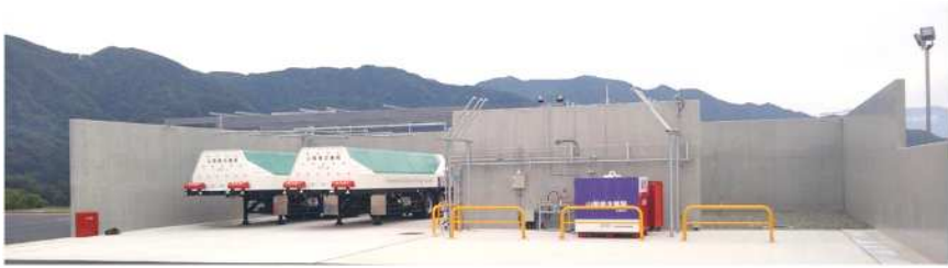
水素出荷設備 19.6MPa 400Nm3/h
