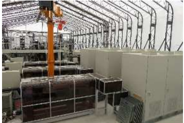
750kW×3列大型スタック 評価設備
