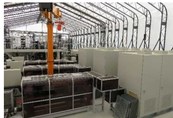
750kW×3列大型スタック 評価設備
