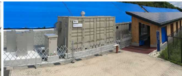
25kW大面積 セルスタック評価設備
