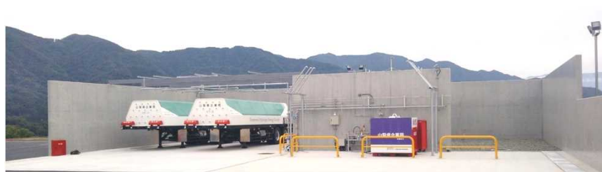
水素出荷設備 19.6MPa 400Nm 3 /h
