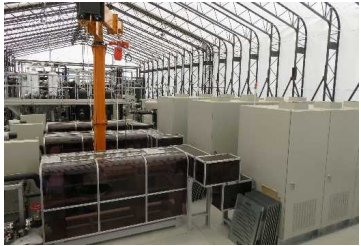
750kW×3列大型スタック 評価設備
