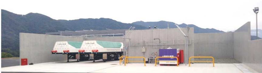
水素出荷設備 19.6MPa 400Nm 3 /h
