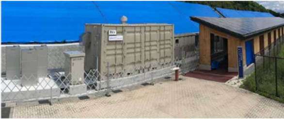
25kW大面積 セルスタック評価設備
