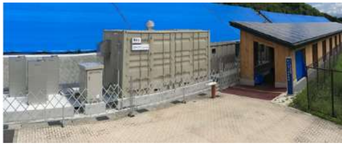
25kW大面積 セルスタック評価設備
