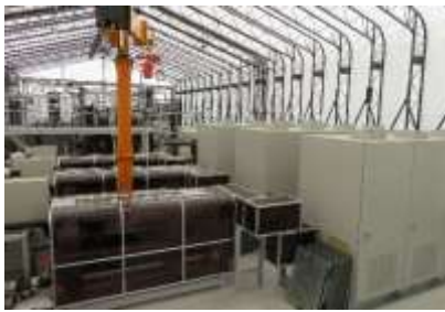
750kW×3列大型スタック 評価設備
