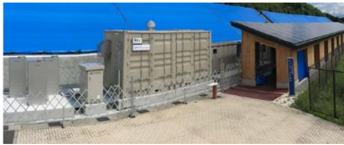
25kW大面積 セルスタック評価設備
