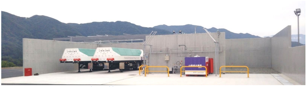
水素出荷設備 19.6MPa 400Nm3/h
