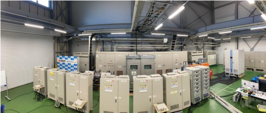
写真. 太陽光・蓄電池用パワーコンディショナの海外認証試験等の実施場所(スマートシステム研究棟 系統連系試験L室)
