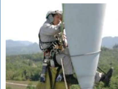
従前の導通試験状況
