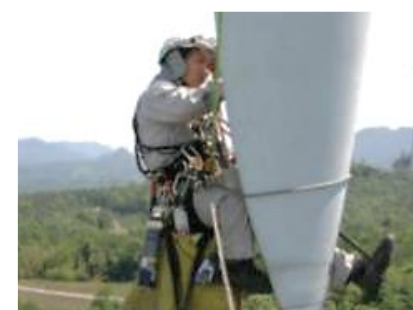
従前の導通試験状況
