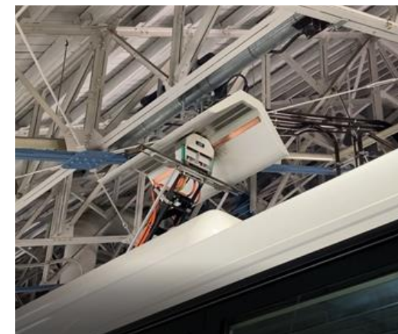
充電設備：パンタグラフとコンタクトドーム
